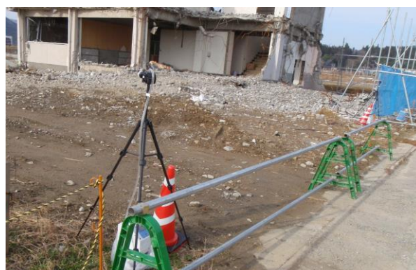
アスベスト大気濃度調査の例（損壊建築物近傍）
